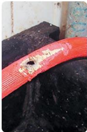
老鼠咬破煤气罐
